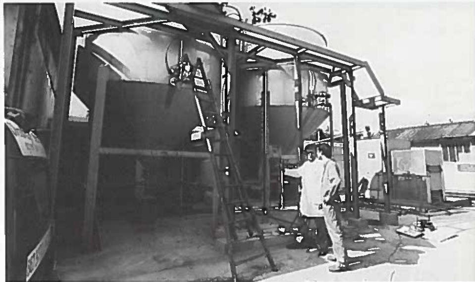
MM. Thomas et Fronty surveillent le chantier de la station de décantation à Fontenay
